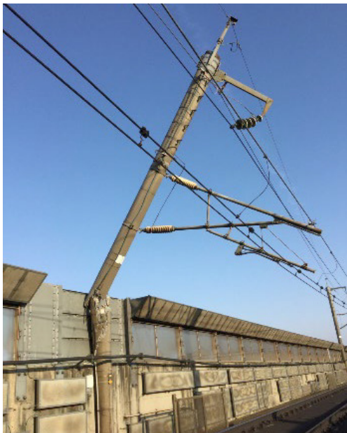
東北新幹線 郡山～福島間の電化柱 JR 東日本プレス発表資料より
