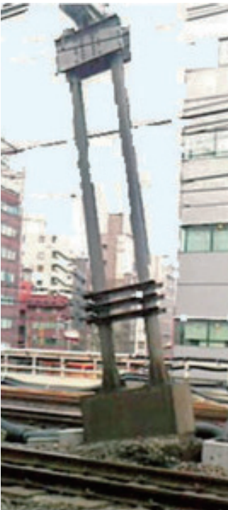
15年4月12日、山手線電化柱倒壊事故。一步間違えば列車直撃の大惨事だったが、並行する京浜東北線の運転士が発見。衝突事故にはならなかった。
